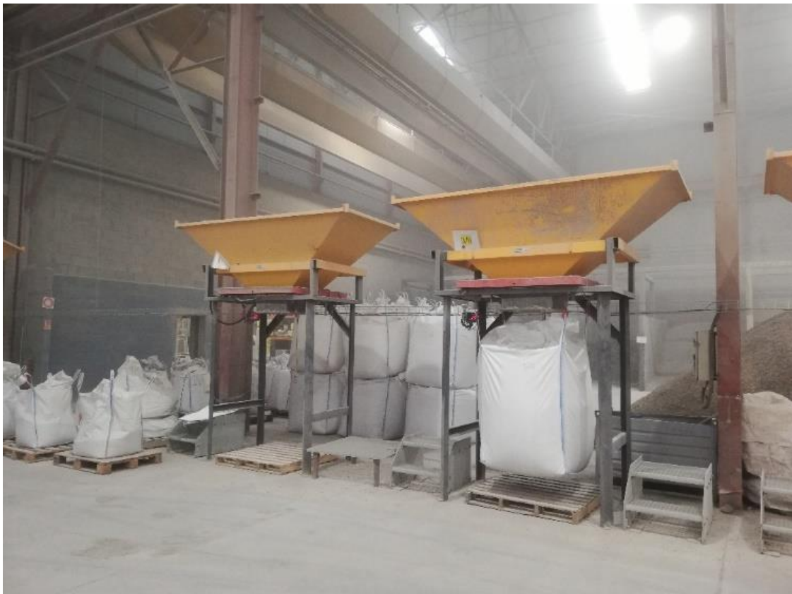
Figure 16 : Station de conditionnement des fractions en big bag
