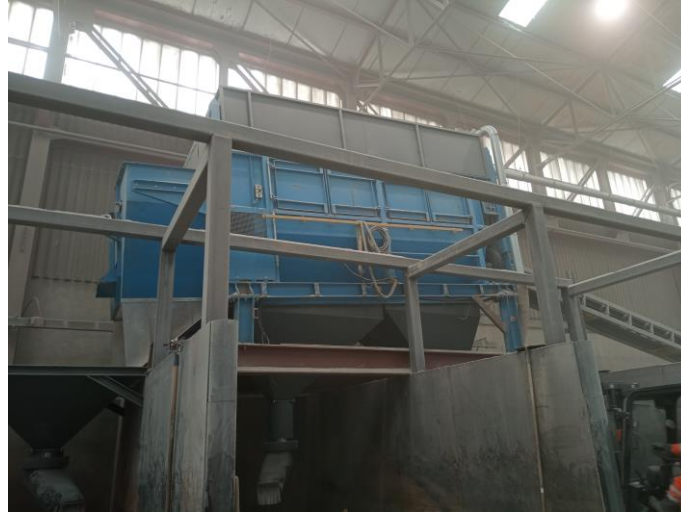
Figure 12: Trommel pour le criblage rotatif
