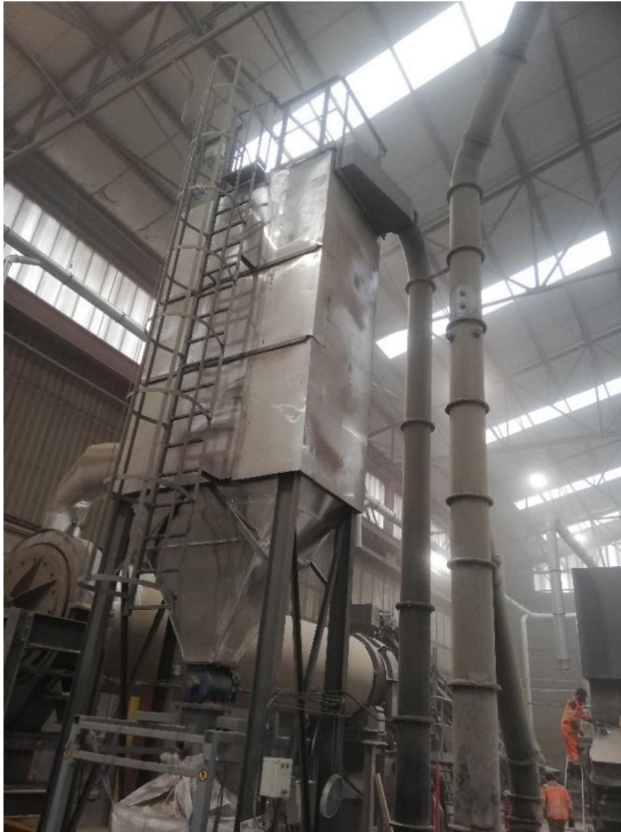
Figure 17 : Système de filtration et mise en big bag de l'appareil de séchage
